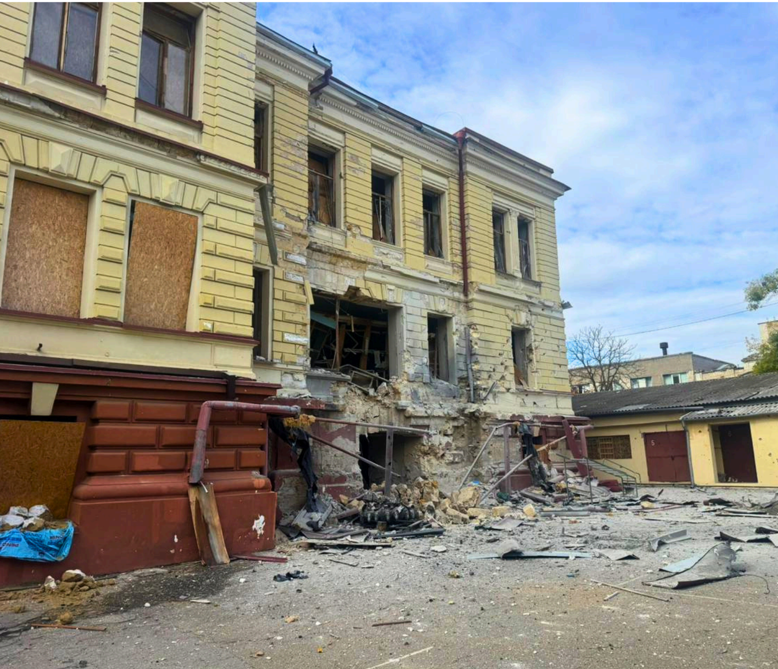
Chersoner Regionalmuseum für Heimatkunde nach dem Angriff vom 18. Oktober 2025. Der UAAC-Hub in Kyjiw lieferte Materialien und Ausrüstung für Notstabilisierungsmaßnahmen, darunter eine Powerstation, Werkzeuge, Baufolie und Verbrauchsmaterialien. © Chersoner Regionalmuseum für Heimatkunde
